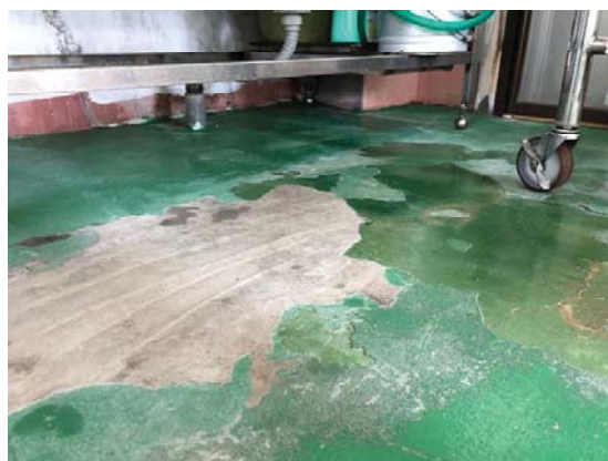
給食室の床の劣化。
